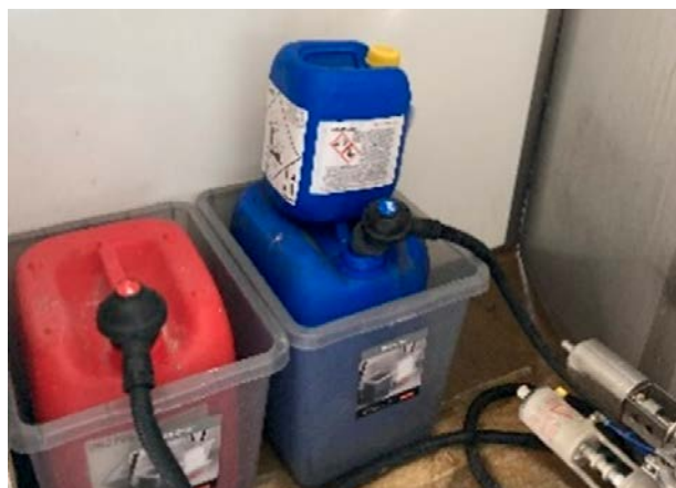
Diskmedelsdunkar placerade i plastlådor för att skydda golvet mot frätskador.
