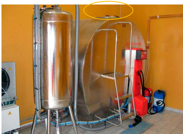
Manlucka (markerad med gul ring) med fri höjd till tak, i ett avhämtningsrum.
