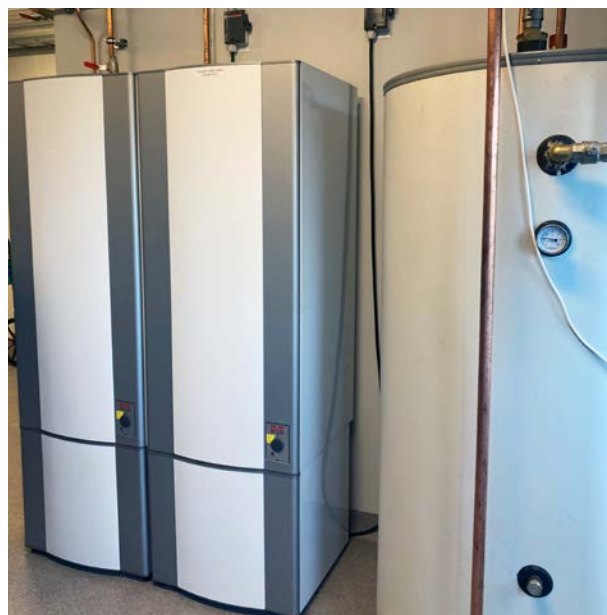
Exempel på sammankopplade varmvattenberedare.
