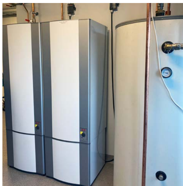
Exempel på sammankopplade varmvattenberedare.
