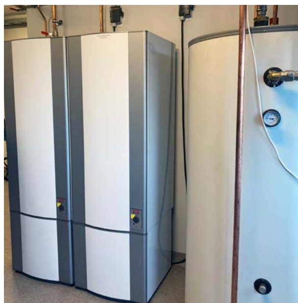
Exempel på sammankopplade varmvattenberedare.
