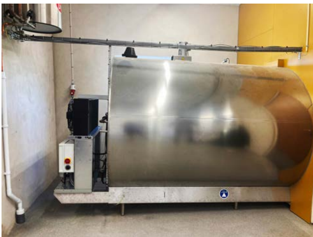
Liggande tank där bakre delen placerats i eget rum med en avskiljande vägg.
