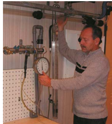
Kontrollstasjon for vakuummeter felles for mjølkemaskinfirmaene og meieriene, Odd Jarle Fiskvik, TINE
