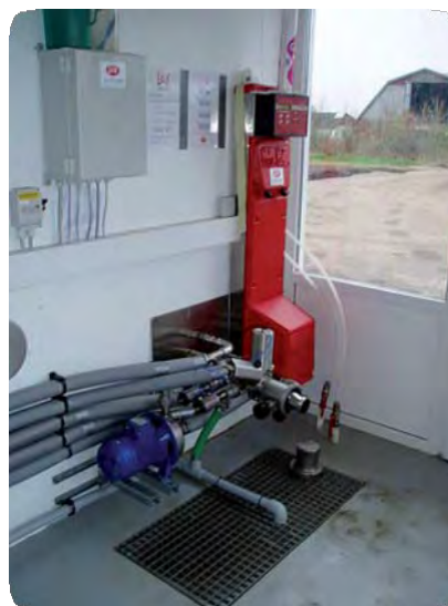
Syrafast golvbrunn med rostfritt galler under tankutloppet.
