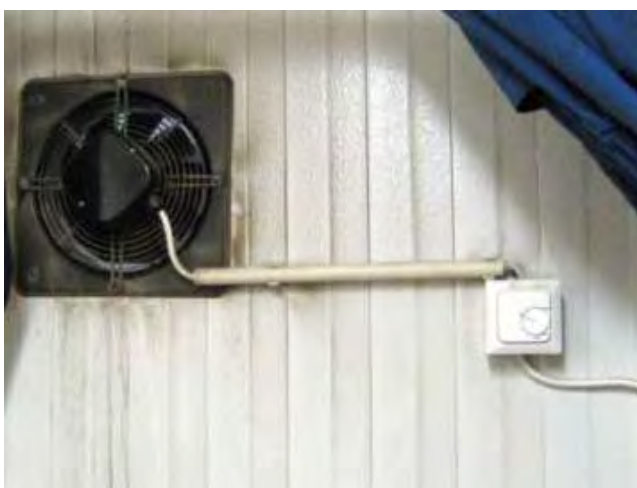
Bilden visar en termostatstyrd fläkt
