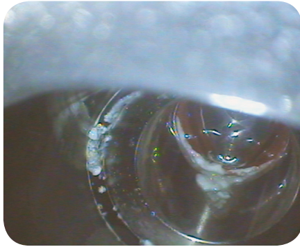
Beläggningar i rör vid ventil till tank. Disktemperatur 42-45°C.
