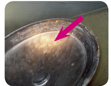
Undersida på manlucka, blir aldrig diskad
