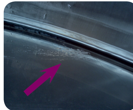
Beläggningar i botten på tank
