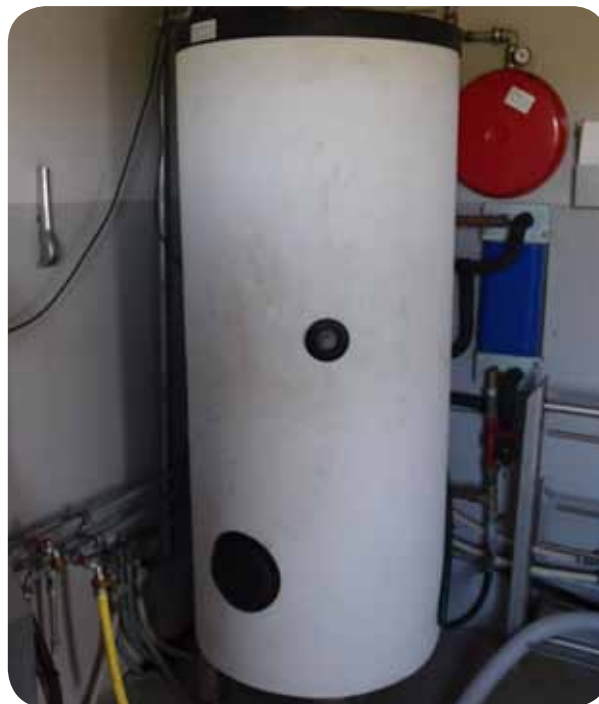
Kontrollera att varmvattenberedaren ger tillräcklig mängd varmt vatten.
